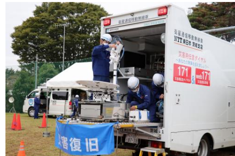
【ポータブル衛星車による災害時用公衆電話の設置】
